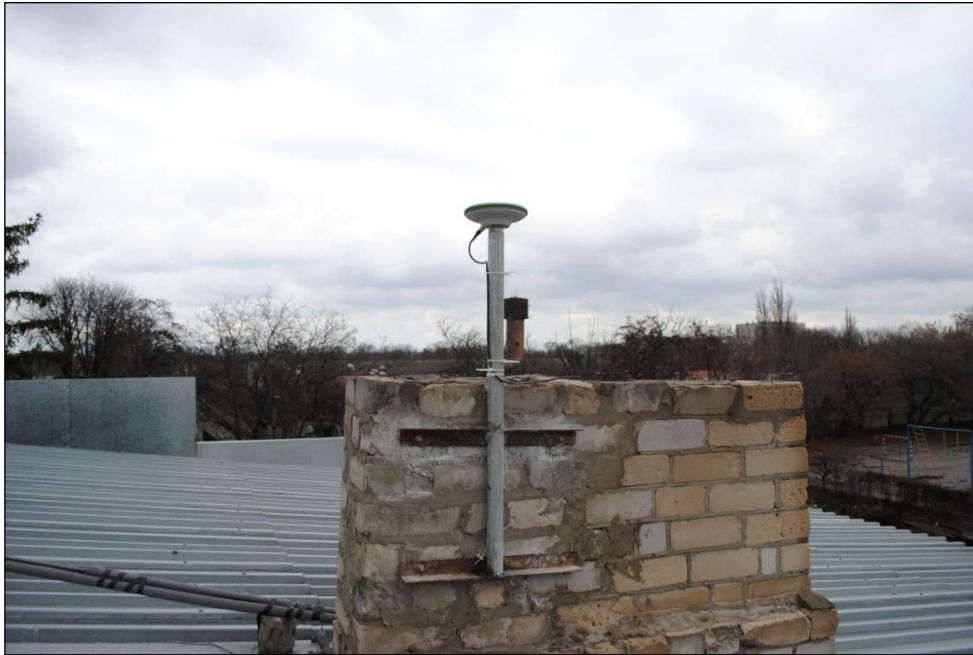
Рисунок 2.5 – Кріплення антени постійно діючої базової станції у місті Красноград
