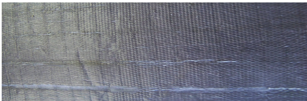
Рисунок - 2 Дефекты наружной поверхности в зоне расположения стыков обшивки с подкрепляющим набором
