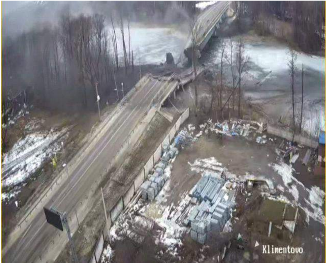
Рисунок 9 Зруйнований міст (з) Климентово [15]
