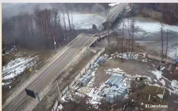
Рис. 8 Зруйнований міст (з) Климентово
