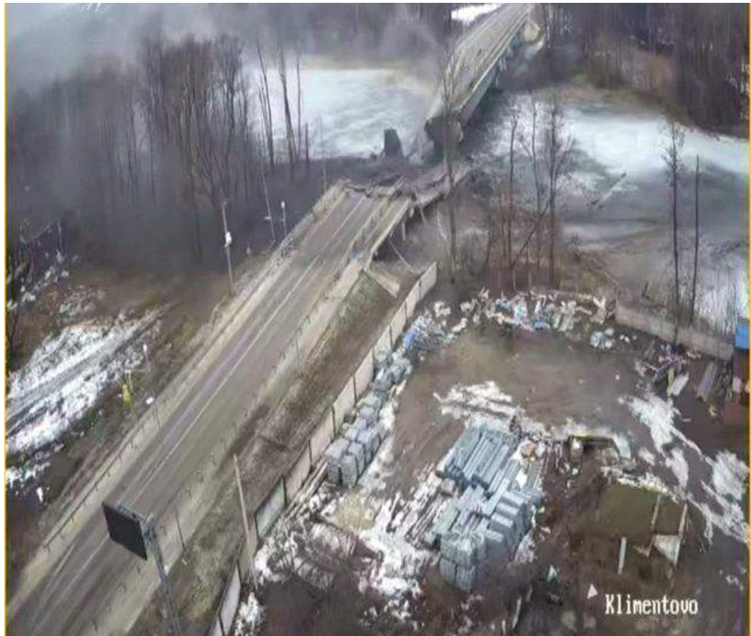
Рисунок 11 Зруйнований міст (з) Климентово
