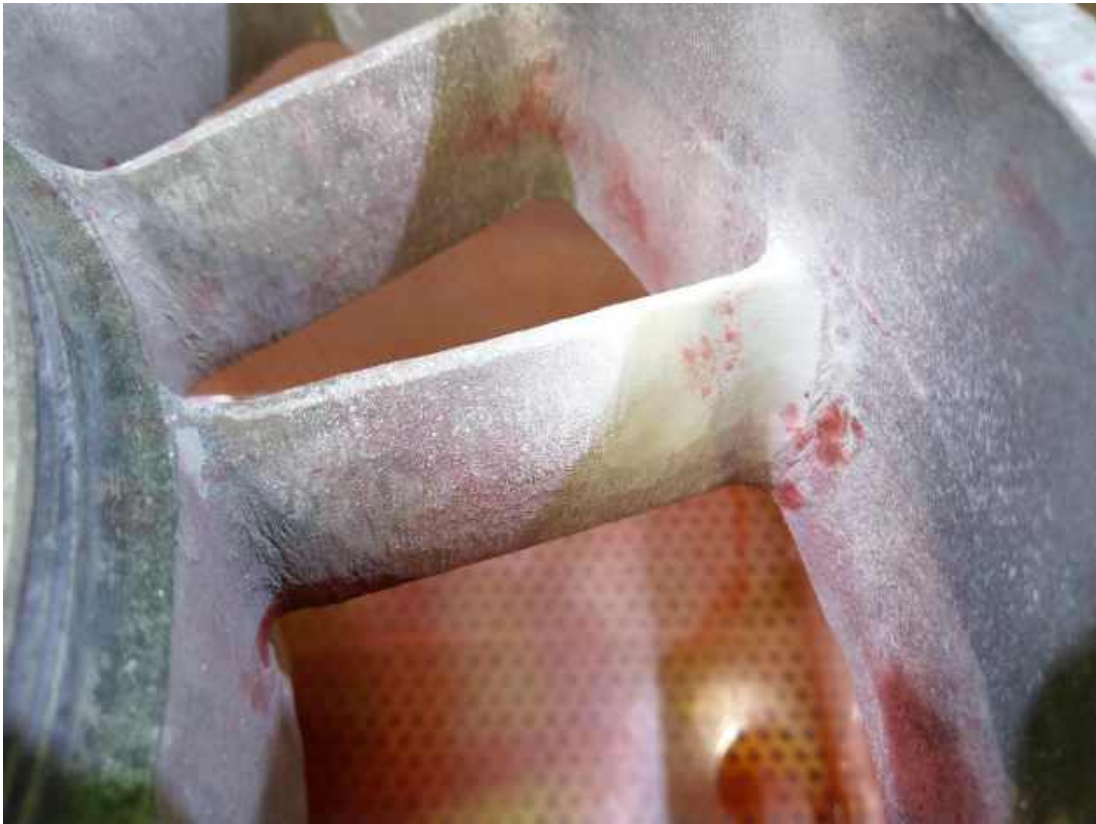
Рисунок 4.9 – Корозія на лопатках вентилятора Мі-8
