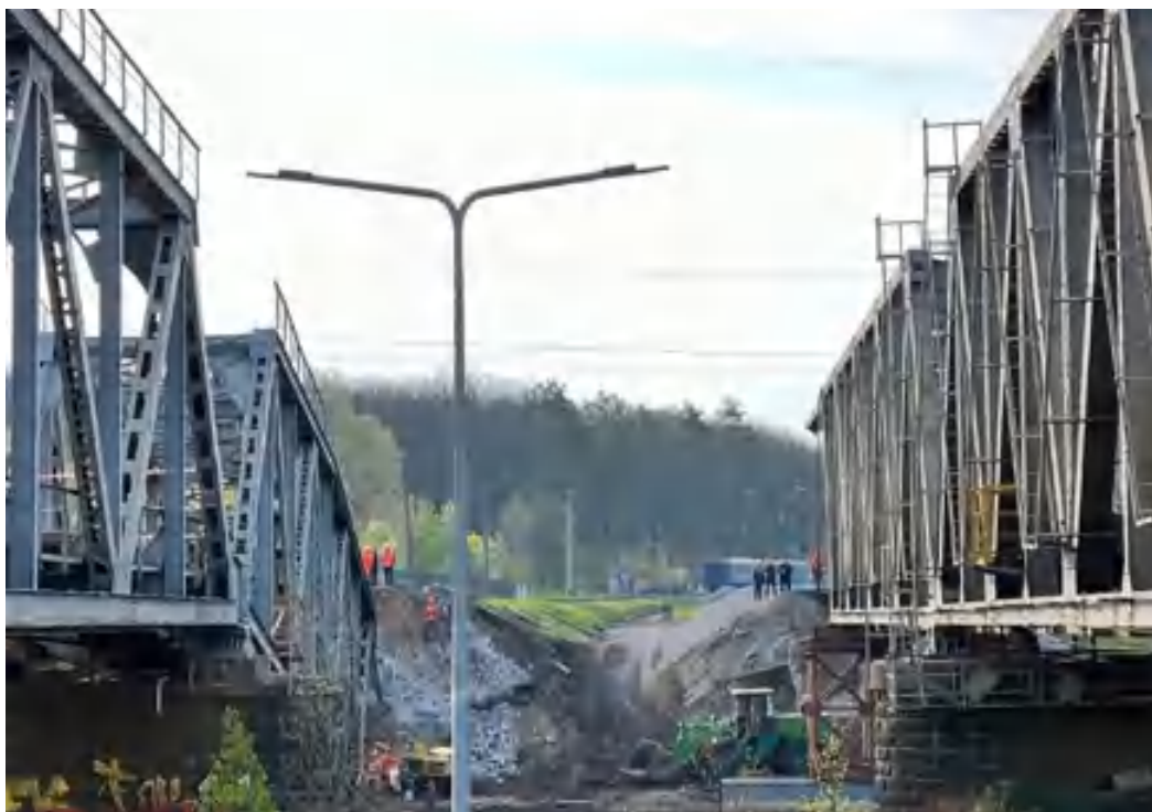
Рисунок 2.6 – Зруйнована «ферма» залізничної дороги в межах міста Ірпінь
