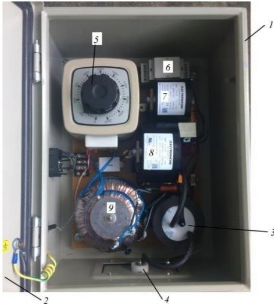
Рисунок 2.15 – Зовнішній вигляд блоку HE-SIS system: 1 – корпус; 2 – кришка, 3 – імпульсний трансформатор, 4 – контрольний розрядник, 5 – регулятор, 6 – формувач, 7, 8 – конденсатори, 9 – підвищувальні трансформатори
